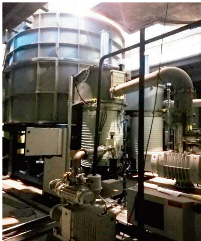
Рис. 1. Установка в сборочном цехе завода-изготовителя
